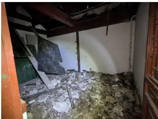
事故现场全景
