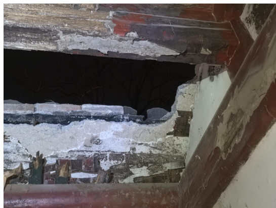
事故现场局部
