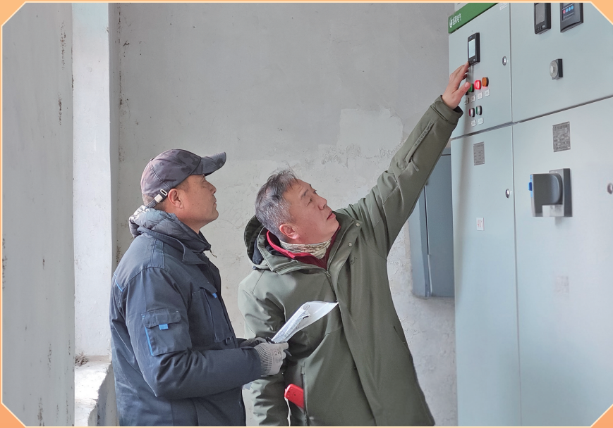
刘伟忠(右一)和同事巡视电力设备。
