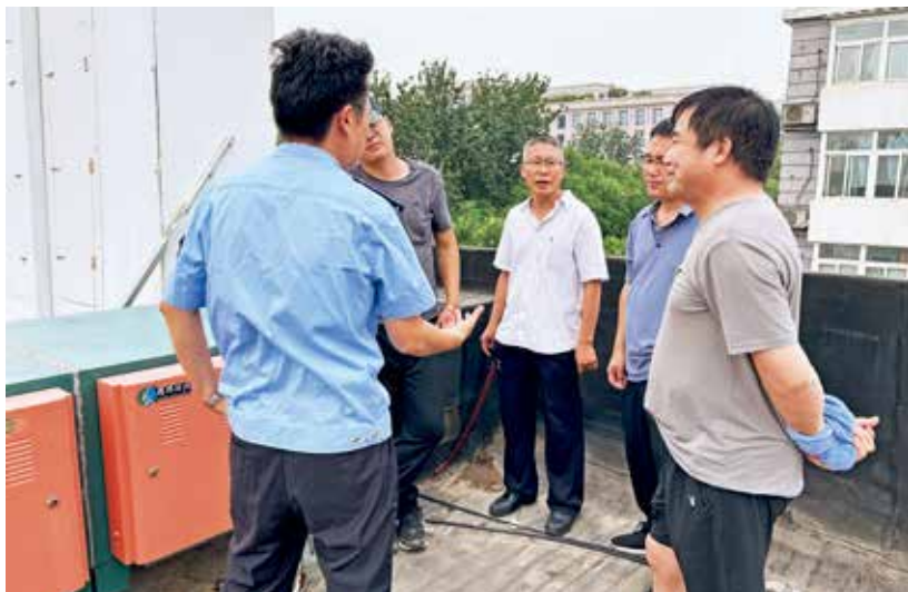
8月8日，区生态环境局工作人员在东华门松鹤楼进行净化器故障检查 （汤霖摄）
