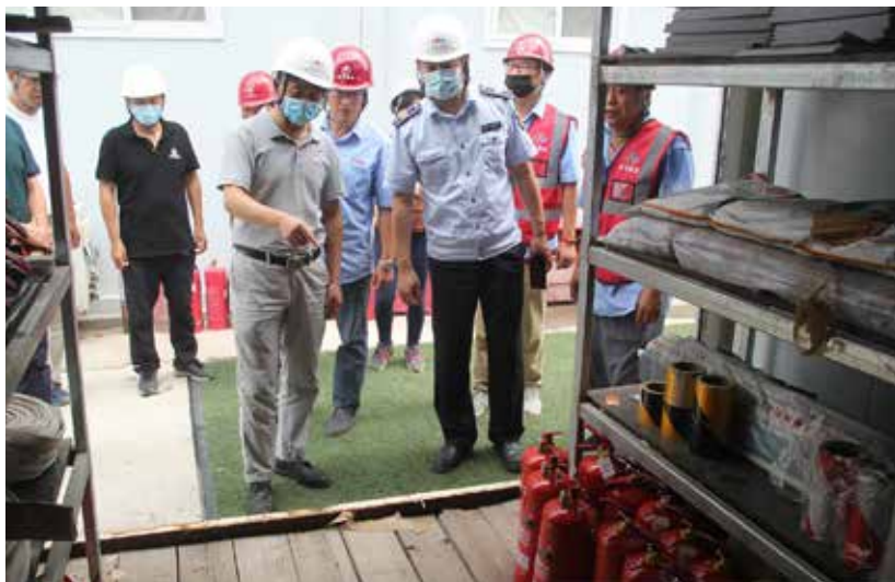
8月12日，佳源公司承建的豆各庄工地接受区国资委防汛安全检查 (王修仁摄)
