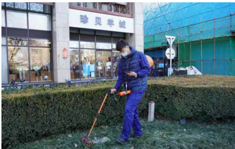
12月30日，燃气、电力工作人员现场对朝阳门南小街徽商故里门前的地下管线和变电箱进行巡查（区城市管理委提供）
